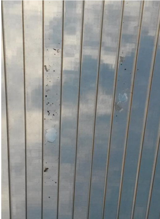
Hagelschäden Balkondach mit Doppelstegplatten
