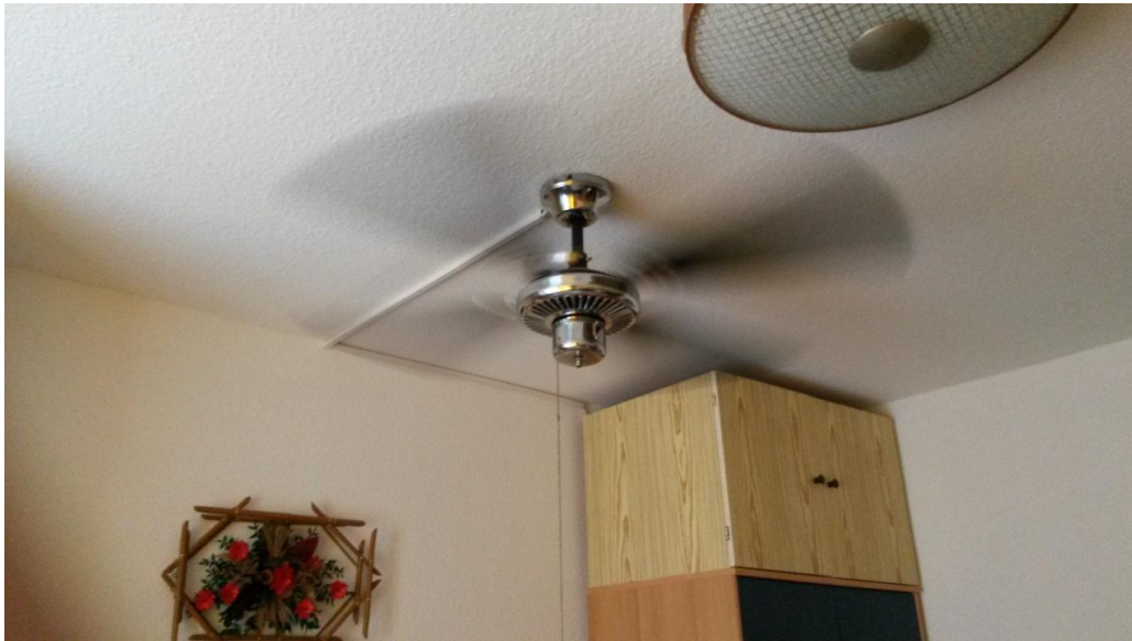
Platzprobleme für Deckenmontage Rauchwarnmelder
